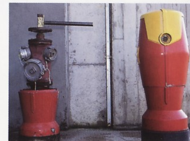
Bornes d'incendie, pour approvisionner les pompiers en eau.
